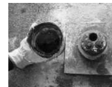
防錆油を入れた痕跡なし
