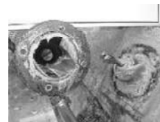
防錆油不足、劣化
