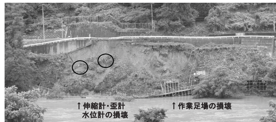
写真:大瀬地区平成26年7月10日の末端崩落時
