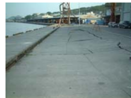
港湾構造物被害
