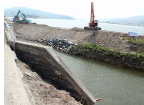
仮復旧状況(視察時撮影)
