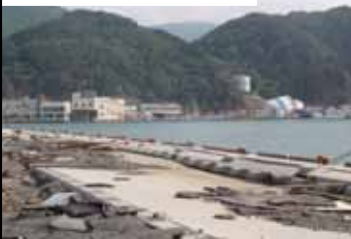
地盤沈下・液状化被害状況
